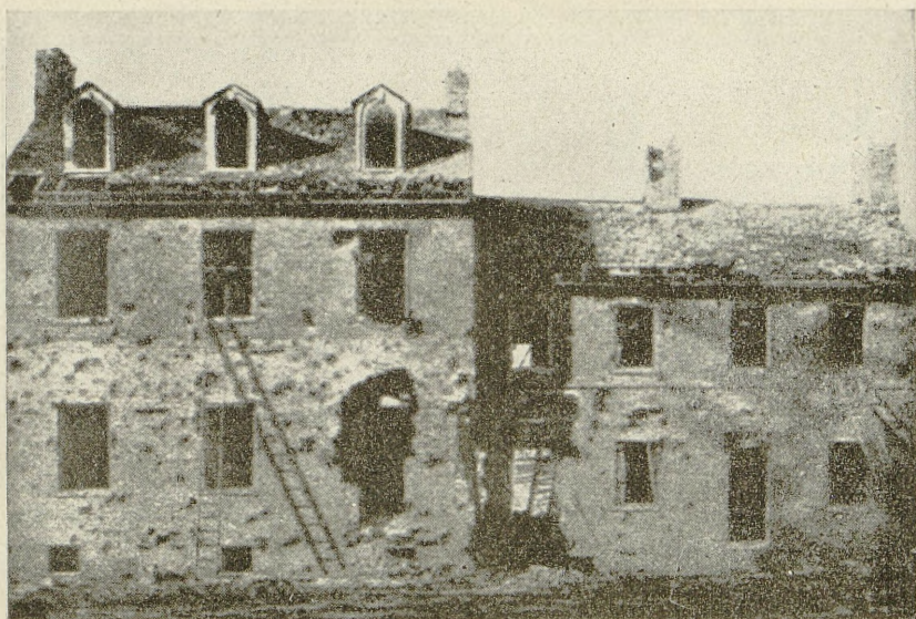
Rys. 4. Działanie podmuchu i odłamków bomby 135 kg, która wybuchła w odległości 7,5 m od domu.
