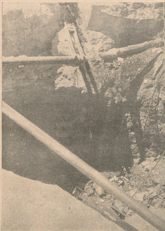
Obnażone przez bombę przewody pod jezdnię.
