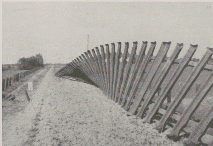
Uchodzący Niemcy zniszczyli tor kolejowy. Germans blew up the track before withdrawal.
