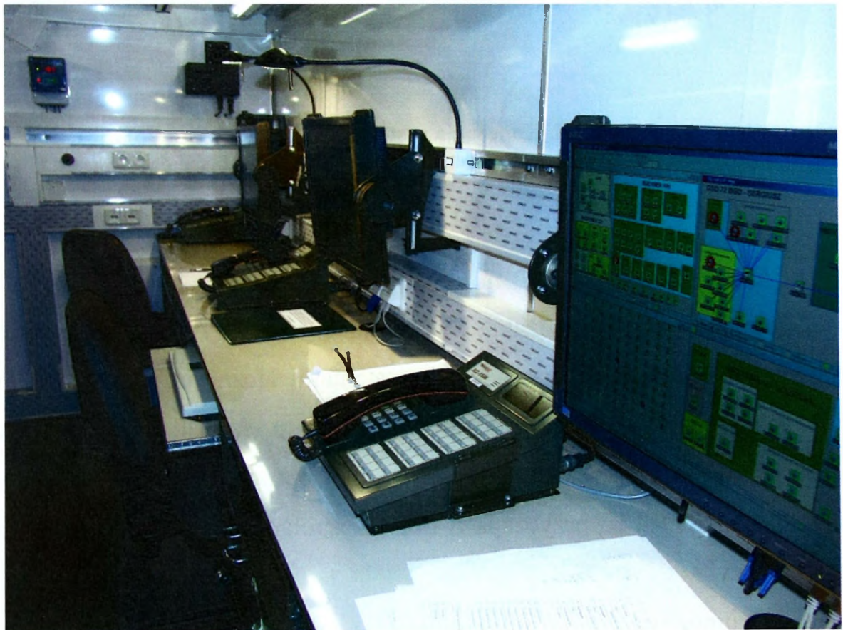
Rys. 4.9. Wnętrze Aparatowni Zarządzania Systemem Łączności Źródło: Zdjęcie własne wykonane na ćwiczeniu „Pierścień 2005”.
